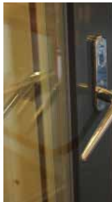
Aukipitolaite lukittu puutteellisesti. Älä yritä liikuttaa ovea väkisin!
